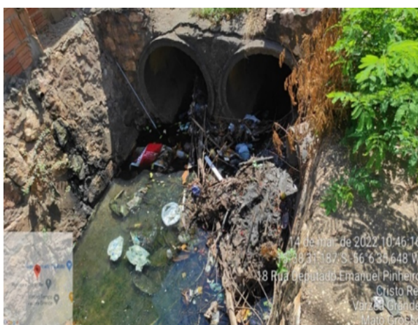
Figura 32 - Resíduos no córrego da Manga
